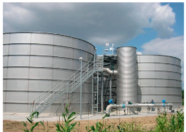
1.664 m 3 Glatstahlbehälter und 51 m 3 Wellstahlbehälter in der Papierindustrie 1,664 m 3 Stainless steel tank and 51 m 3 corrugated steel tank in the paper industry
