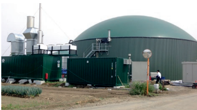
Biogasbehälter mit Doppelmembrandach in Japan Biogas tank with double membrane roof in Japan
