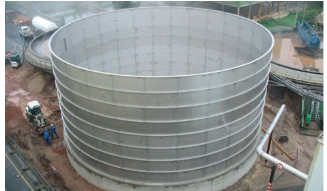
1.661 m 3 Abwasserbehälter für die Papierindustrie 1.661 m 3 Waste water tank for the paper industry
